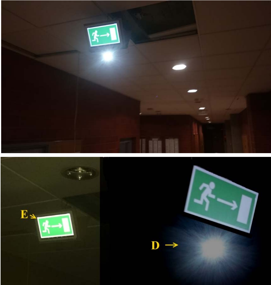
Fot. 5. Widok oprawy E-LCD/OLED pracującej w warunkach rzeczywistych oświetlenia ewakuacyjnego korytarza w budynku Wydziału Elektrycznego PB (źródło: Autorzy)
