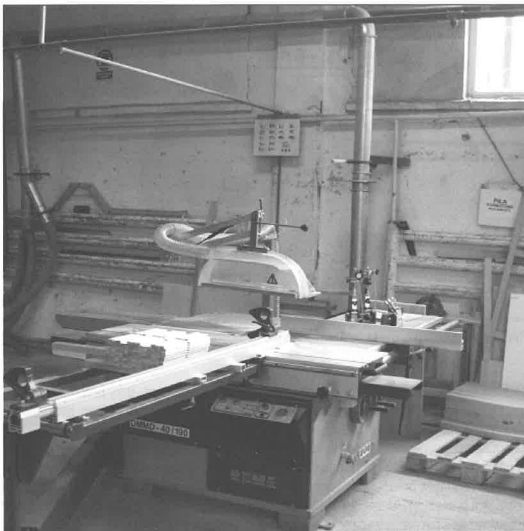
Rys. 14. Osłony podłączone do instalacji wentylacji miejscowej
