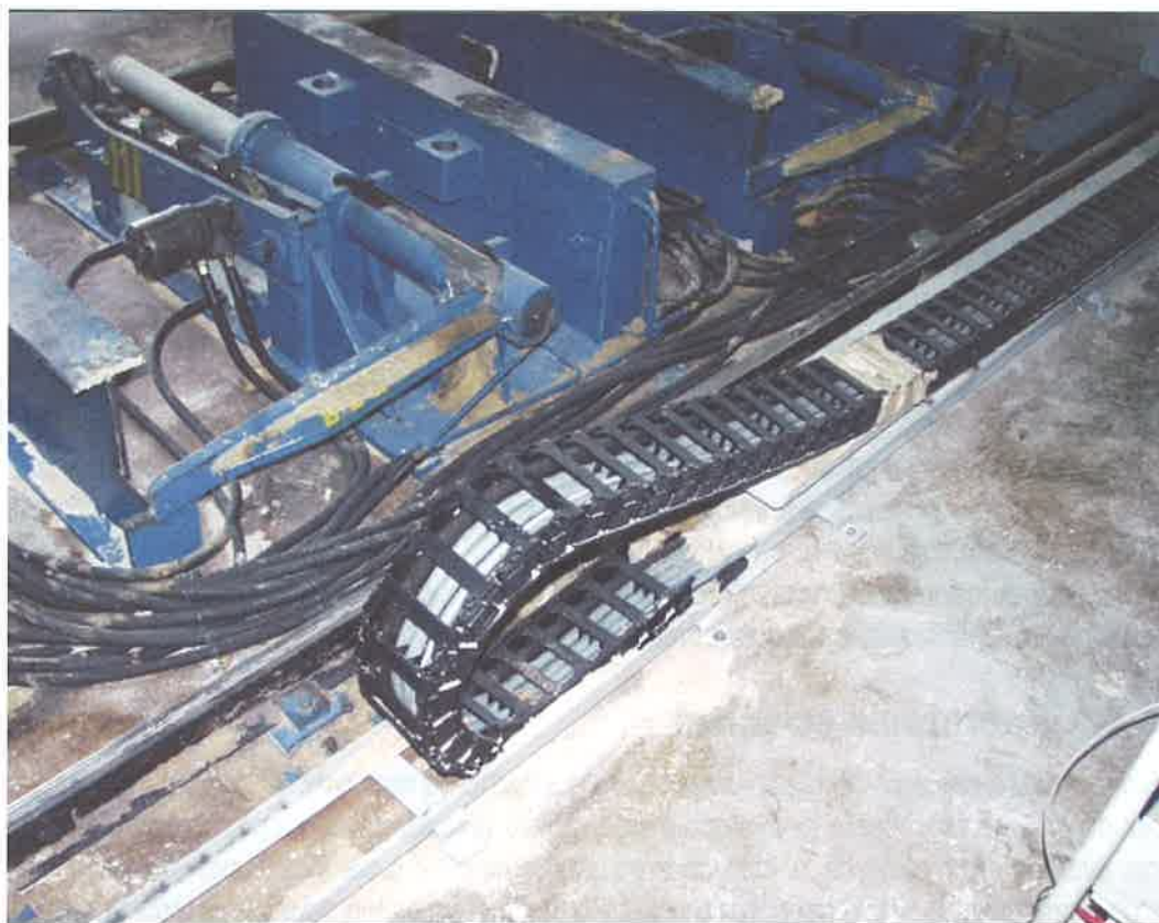
Rys. 8. Kable i przewody na stanowisku przecierania kłód w tartaku
