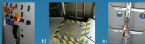
Rysunek 4. Sprzęt i wyposażenie: a) telefon do komunikacji z gondolą; b) pokrywa oddzielająca kolejną kondygnację wieży; c) urządzenie samozaciskowe chroniące pracownika przed upadkiem.
