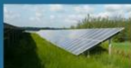
Rysunek 2. Rząd paneli fotowoltaicznych w elektrowni słonecznej
