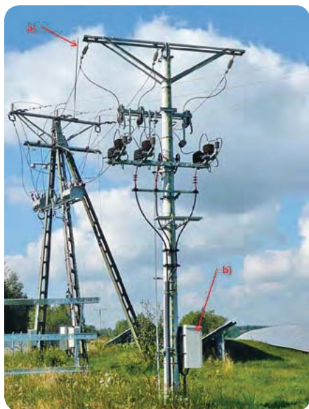
Fot. 4. Słupy sieci energetycznej SN, z którą połączona jest elektrownia fotowoltaiczna: a) głowica piorunochronu – zwód pionowy instalacji odgromowej; b) obudowa rozdzielni z odłącznikiem izolacyjnym całej instalacji
