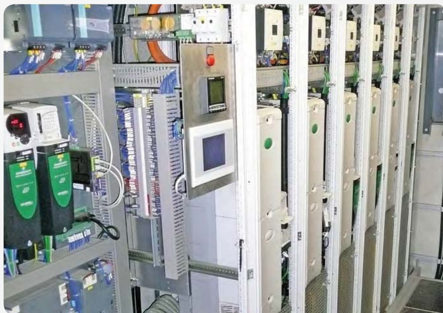
Fot. 3. Wnętrze sterowni elektrowni fotowoltaicznej Photo 3. Photovoltaic power plant control room's interior
