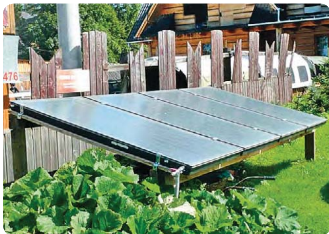
Fot. 1. Instalacja naziemna cieczowych kolektorów słonecznych (fot. tu i dalej: Mariusz Dąbrowski)
