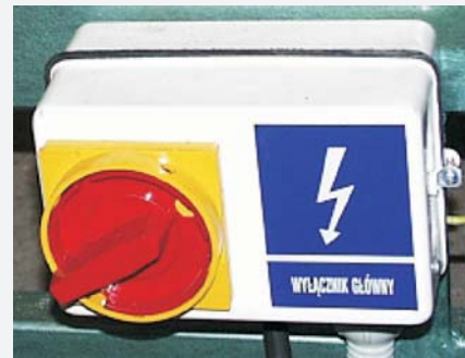
Fot. 10. Prawidłowy rozłącznik główny maszyny Photo 10. A proper machinery main switch
