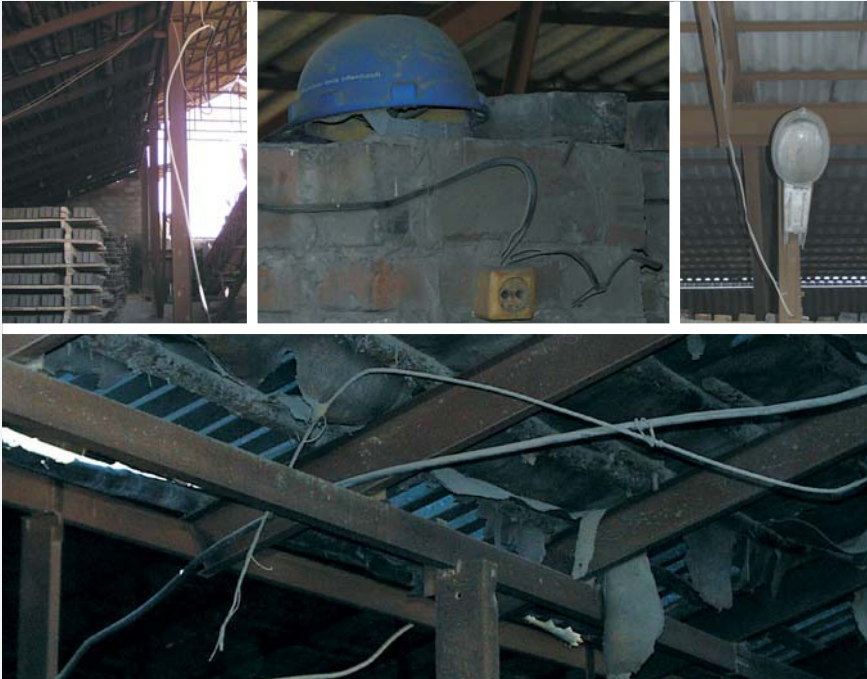
Fot. 9. Przykłady nieprawidłowego prowadzenia przewodów Photo 9. Examples of incorrect wire conduction schemes
